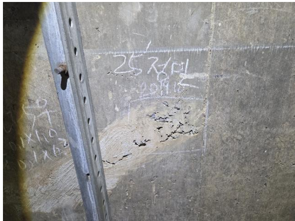
내용 종점벽체 Sta.26m 재료분리
