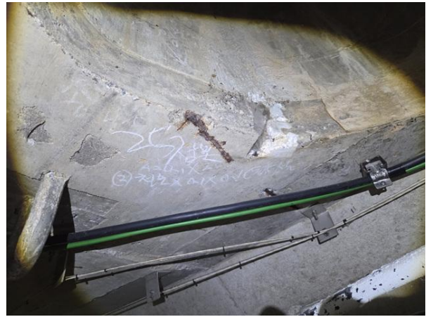
내용 상부슬래브 Sta.25m 철근노출
