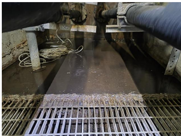
내용 바닥 Sta.31m 체수
