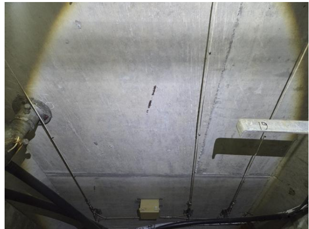
내용 상부슬래브 Sta.31m 철근노출
