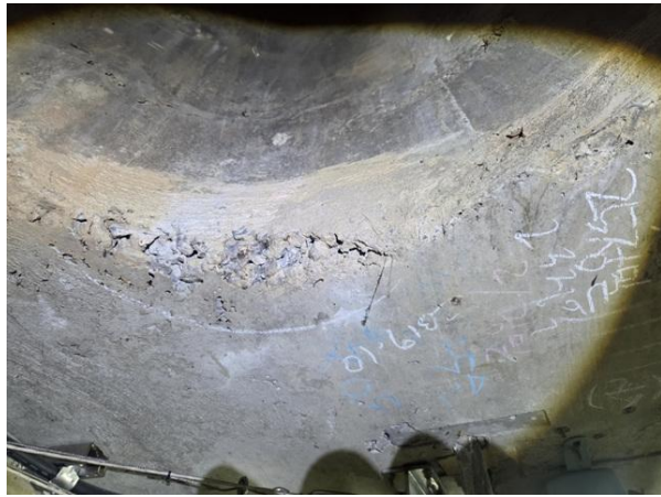
내용 상부슬래브 Sta.24m 재료분리
